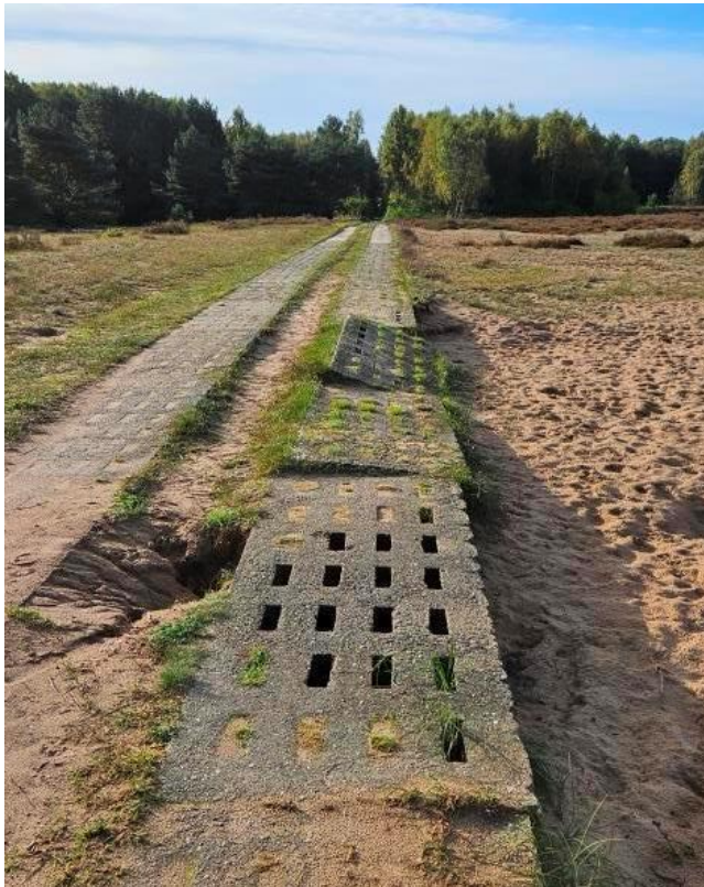
Abb. 60: Kolonnenweg mit defektem Belag (Foto tBL)
